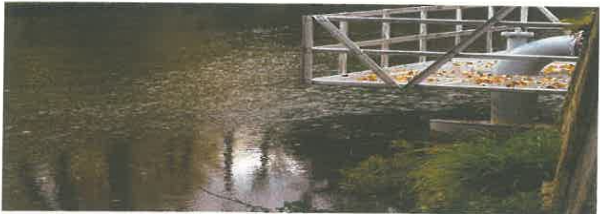
Fig. 13: Detalle de la captación en el Bombeo El Berrón
