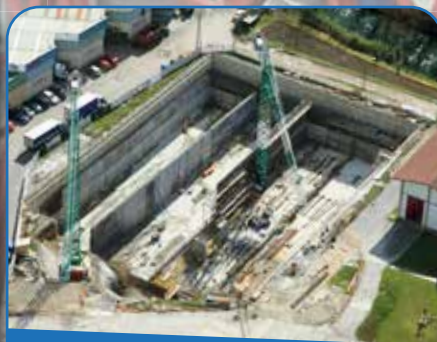
Tanque de tormentas (Arriandi)
