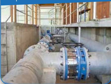
Dep. Landatxas. Sala de válvulas
